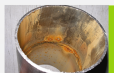
Rys. 2. Powierzchnia wewnętrzna rurociągu z widocznymi rdzawymi osadami i wykwitami
