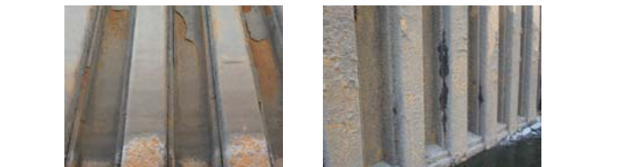
Rys. 6. Śluza Rudziniec. Przykładowe uszkodzenia na ścianie zewnętrznej komory południowej. Widoczne obszary korozji płytowej oraz miejsca perforacji profili Larsena (ślady wycieków wody)
