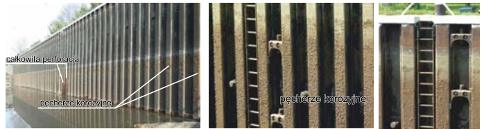
Rys. 4. Śluza Łabędy. Ściana zewnętrznej komory północnej śluzy z widocznymi „pęcherzami korozyjnymi” oraz miejscami z całkowitą perforacją profili Larsena
