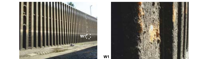
Rys. 7. Pęcherze korozyjne na ścianie zewnętrznej komory północnej Śluzy Rudziniec
