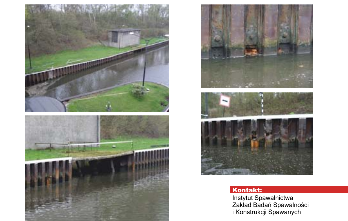
Rys. 10. Śluza Dzierżno Awanport od strony wody dolnej z wybranymi uszkodzeniami
