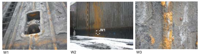
Rys. 9. Śluza Dzierżno. Przykłady korozji na ścianach komór śluzy w okolicy pachola cumowniczego (W1), na ścianie (W2) i zamka (W3)
