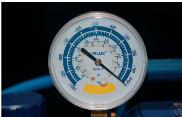
Rys. 7. Widok tarczy manometru wbudowanego w obwód pompy próżniowej
