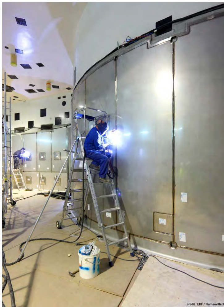
Rys. 9. Wykładzina ze stali nierdzewnej wewnętrznego zbiornika wody zapasowej IRWST elektrowni Flamanville 3. Zdjęcie: EDF/Flamanville 3 [16]
