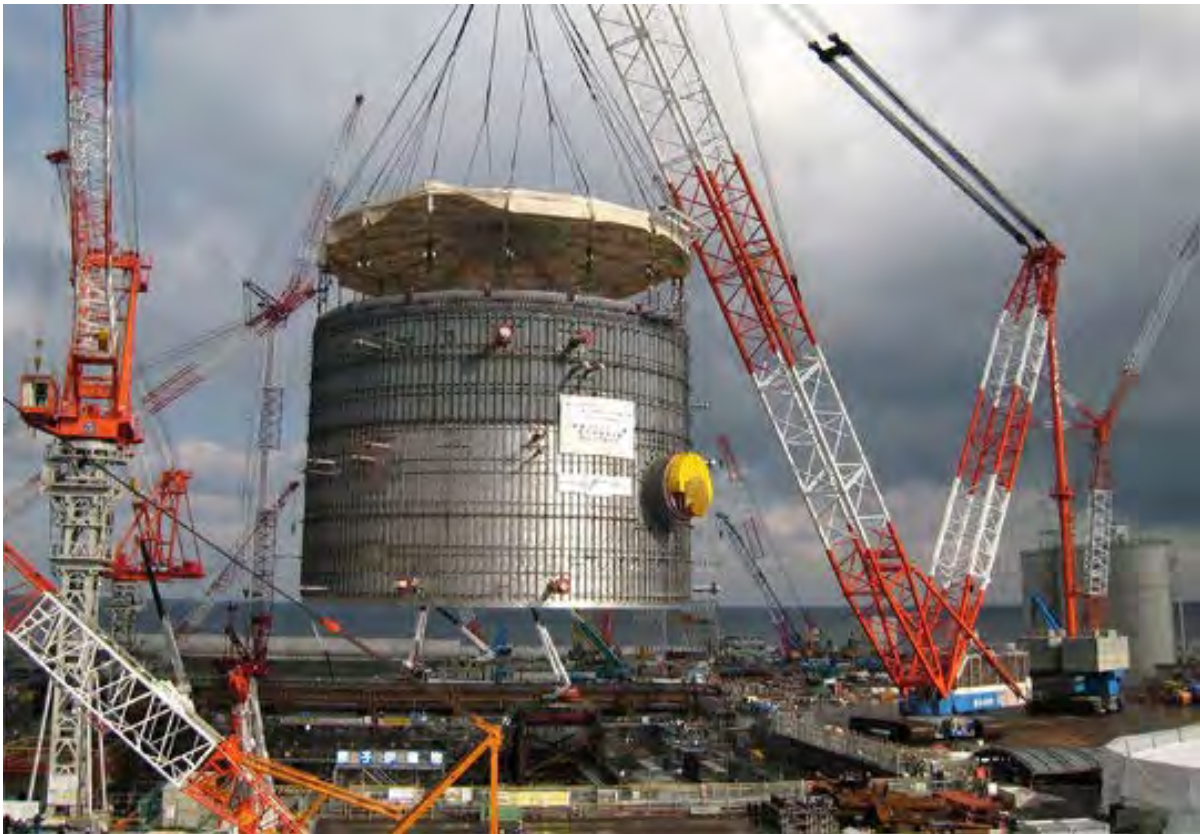
Rys. 20. Dolny pierścień cylindryczny płaszcza stalowego (RCCV Lower Liner Module) reaktora ABWR firmy GE Hitachi [27]
