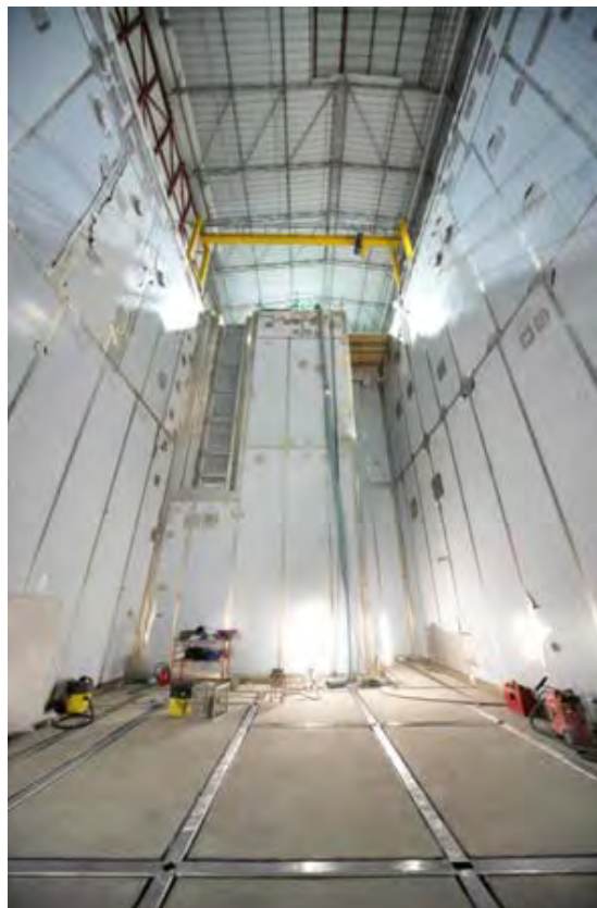
Rys. 7. Budynek paliwowy: basen do przechowywania prętów z wypalonym paliwem z poszyciem ze stali nierdzewnej. Zdjęcie: EDF/Flamanville 3 [14]
